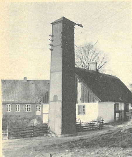
Til træningsløb og sommetider i køreordrer kan der blive opgivet en betegnelse som „Trf.St.“, og her er der så tale om en Transformatorstation som den viste.
